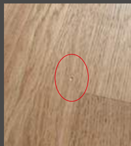
Boden mit Beschädigung
