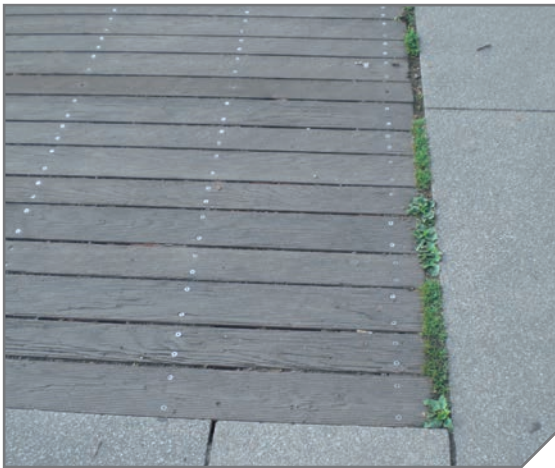
Fugen sollten immer sauber gehalten werden und Laub, Dreck und Unkraut muss entfernt werden.
