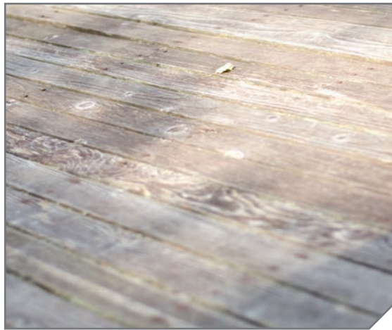
Vergraute Oberfläche von Terrassendielen
