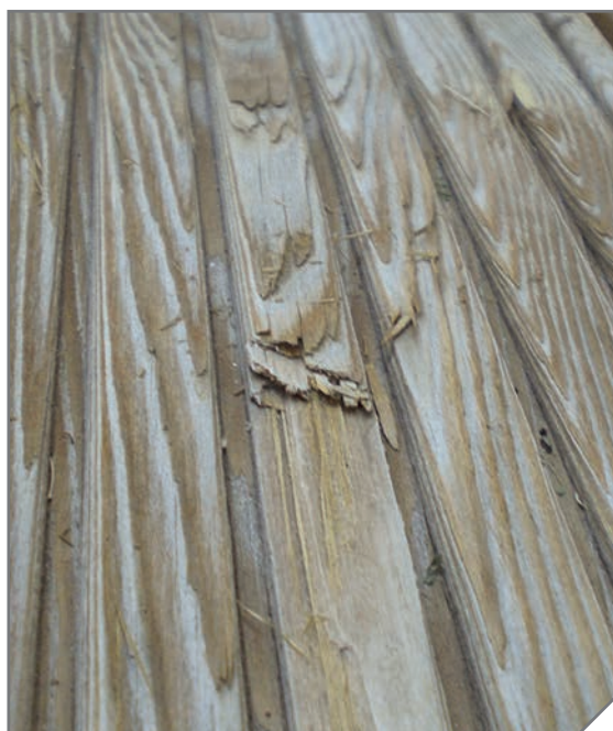
Ringschäle und Schilferrisse können auf der rechten Seite der Dielen entstehen.
