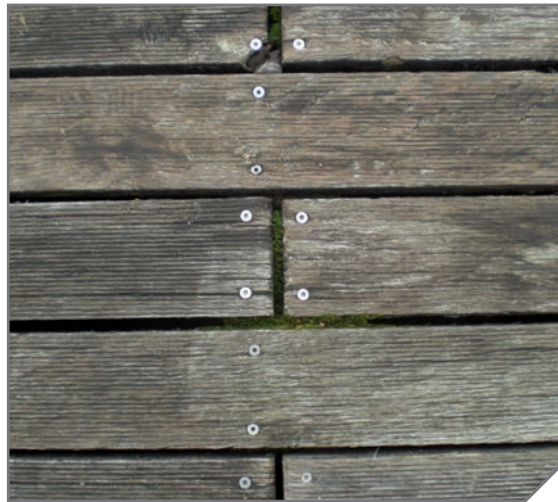
Moos und Dreck in den Fugen führten zur Pilzbildung und vorzeitigem Ausfall von Dielen.
