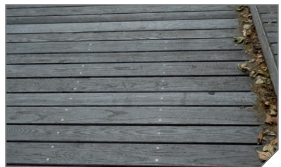
Laub und Schmutz muss aus den Fugen entfernt werden, damit keine Pilze entstehen können.
