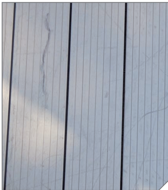
Auf WPC-Terrassen können Kratzer durch Möbelgleiter entstehen.
