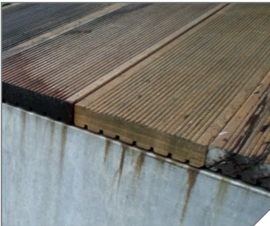
Auswaschungen aus Bangkirai, die sich nur durch eine konstruktive Lösung verhindern lassen.
