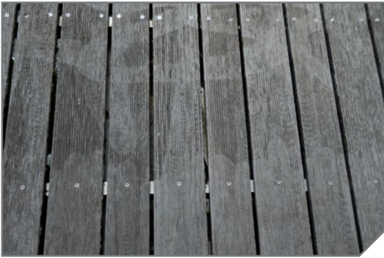
Fläche wurde mit dem Hochdruckreiniger gereinigt, sichtbare Spuren sind auf der Oberfläche vorhanden.
