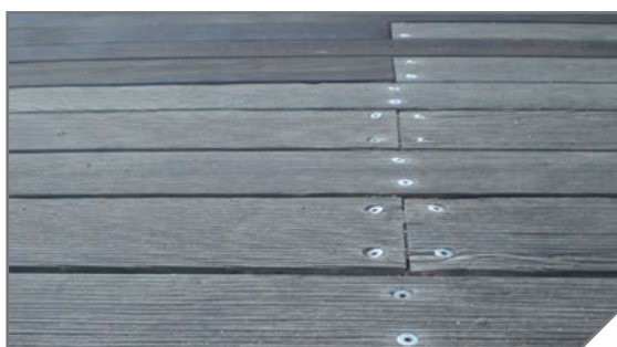
So sollte eine Verschraubung nicht aussehen. Die Schrauben sind nicht in einer Flucht geschraubt.
